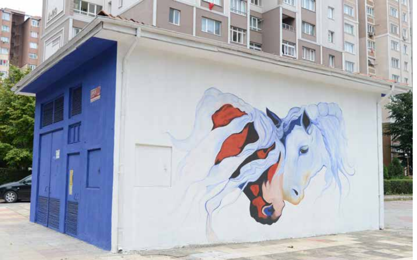
Çamlık Caddesi Üzeri trafo süsleme
